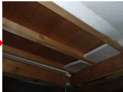
断熱材がない
