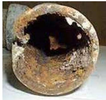
亜鉛メッキ鋼管の腐食例
