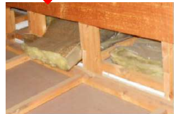
断熱材がない
